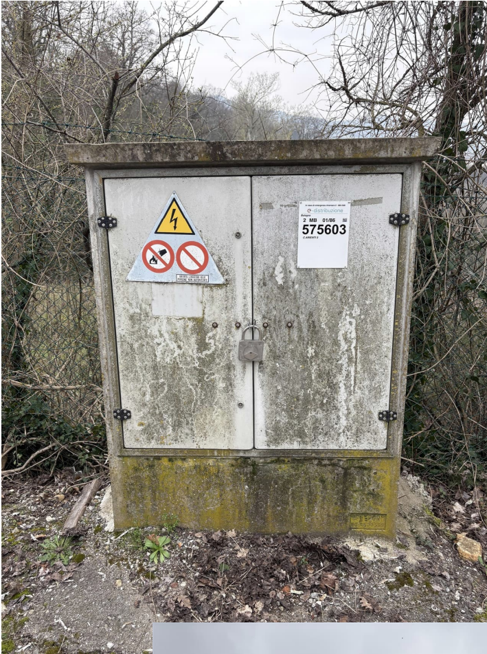
Foto 13- Armadio Enel del trasformatore MT -BT
