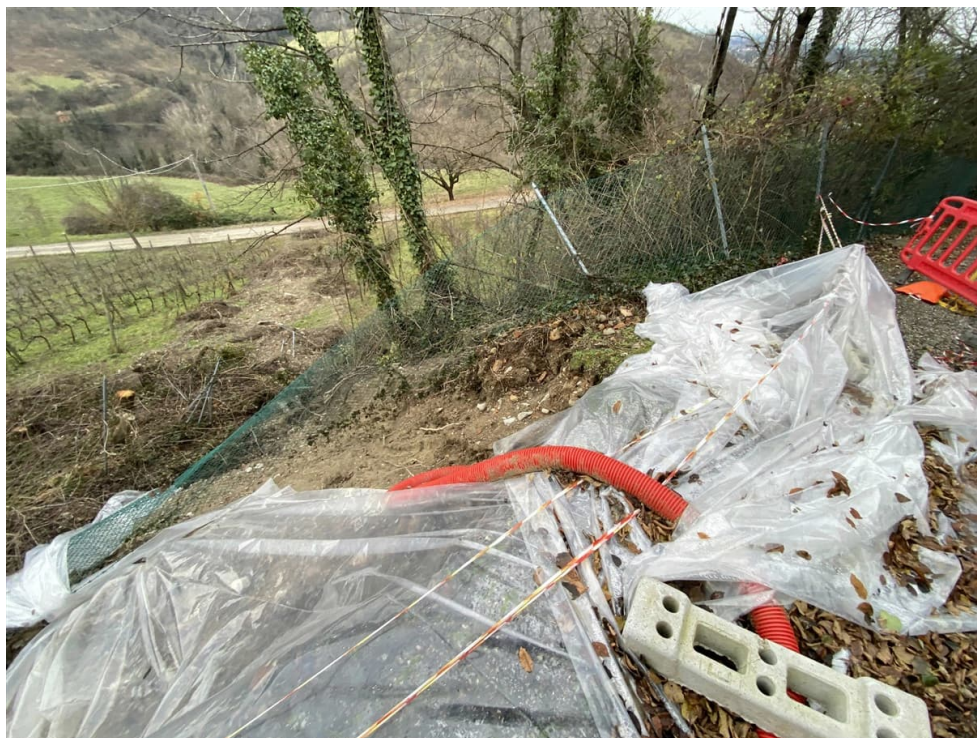
Foto 3 – Vista dall'alto del tratto di scarpata franato
