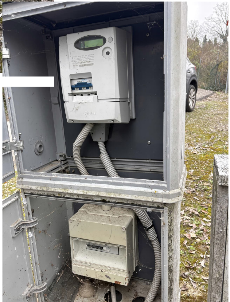
Foto 12 – Conatore Enel del cavo fuori terra
