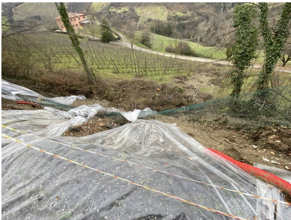
Foto 2 – Vista dall'alto della porzione di scarpata franata
