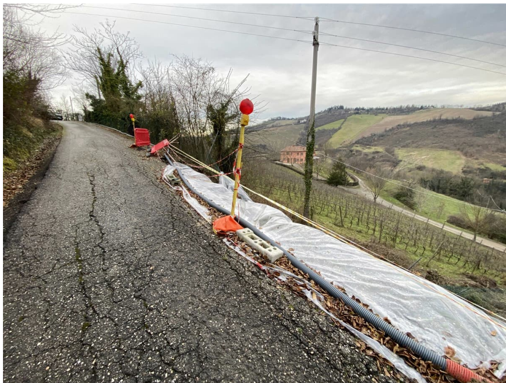
Foto 1 – Vista dalla strada del tratto interessato dalla frana
