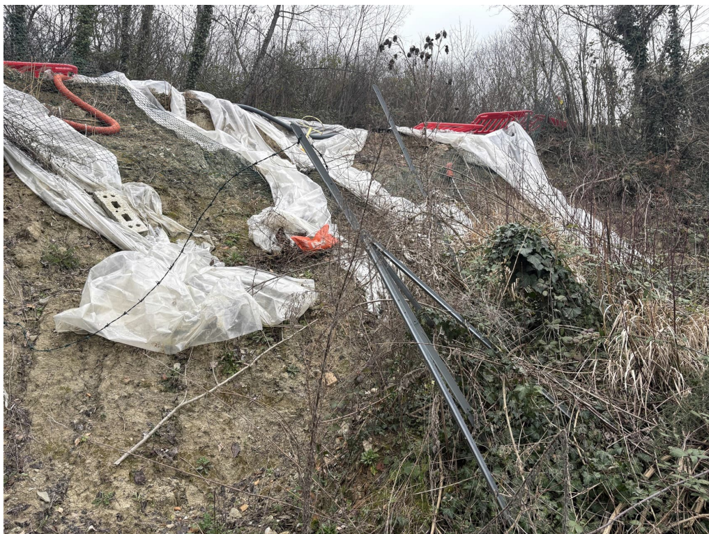
Foto 15 – Vista dal basso della frana
