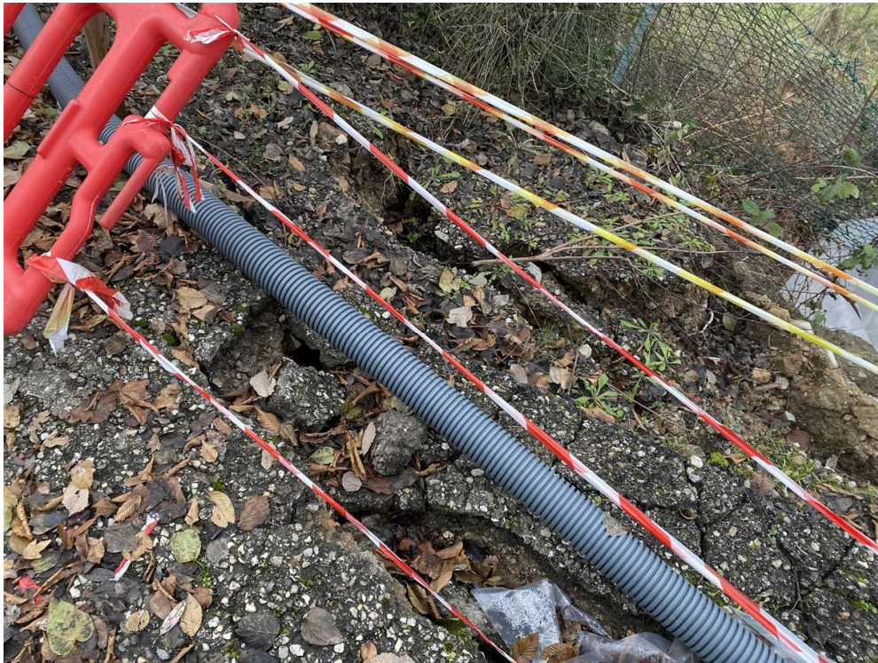
Foto 8 – lesione nella banchina, lato alto
