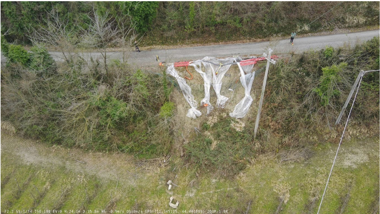
Foto 19 – Vista dal drone della frana
