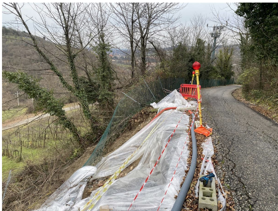
Foto 4 – Vista dall'alto del tratto di scarpata franato
